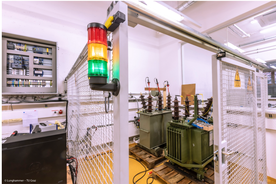
Abbildung 17. Transformatoren im Testbereich. Quelle: TU Graz/Lunghammer.
